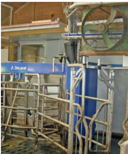
Bild 5: Ein Ventilator in unmittelbarer Nähe der Melkbox sorgt für kühles Klima.
